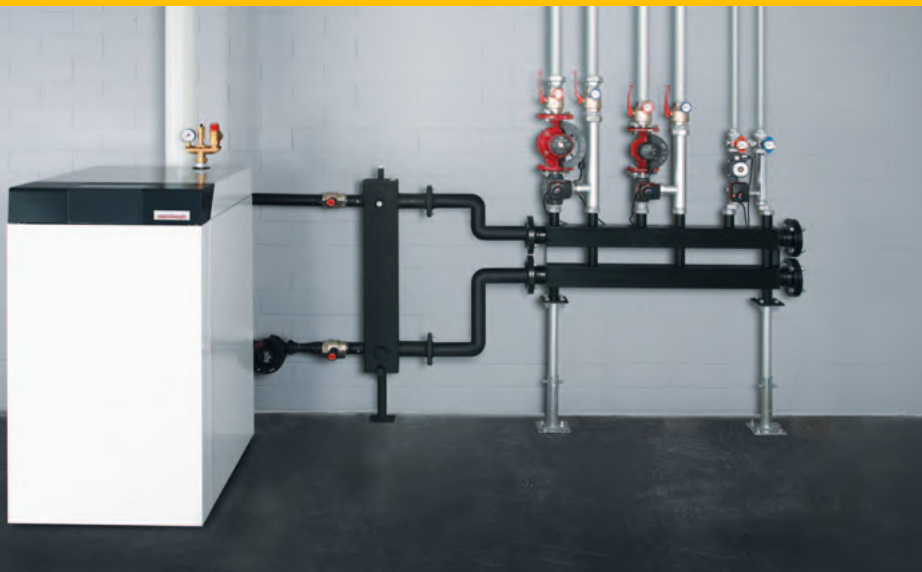
Gas-Brennwertkessel WTC-GB mit Hydraulikkomponenten (ohne Wärmedämmung)
