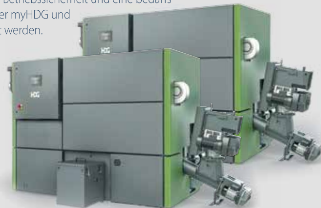
Beispiel einer HDG Kaskade mit zwei HDG Hackschnitzelheizungen.
